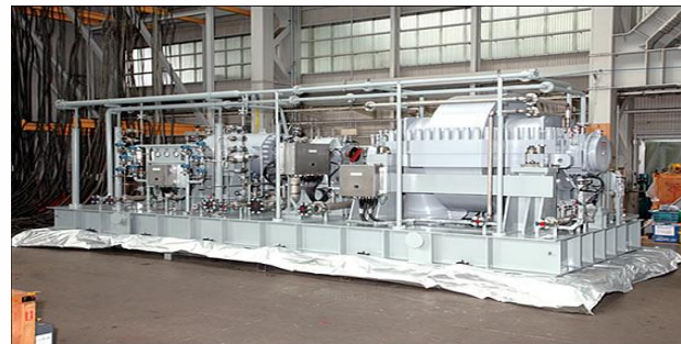
Hệ thống theo dõi bộ nén CO 2 (Công ty CP Phân bón Dầu khí Cà Mau)
